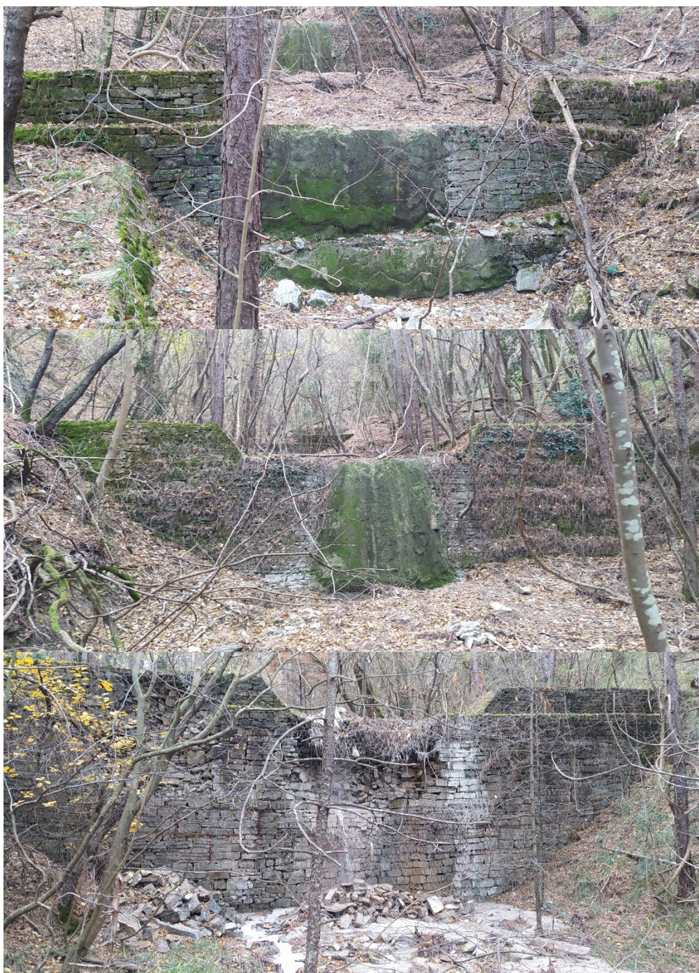
Figure 13: esempi di briglie presenti lungo l'asta del torrente Trnovska censite nel 2025. a) briglia n. 250 in gabbioni con elevata presenza di vegetazione a monte della struttura; b) briglia n. 260 in gabbioni con elevata presenza di vegetazione a monte e a valle della struttura; c) briglia n. 210 in gabbioni significativamente danneggiata.
