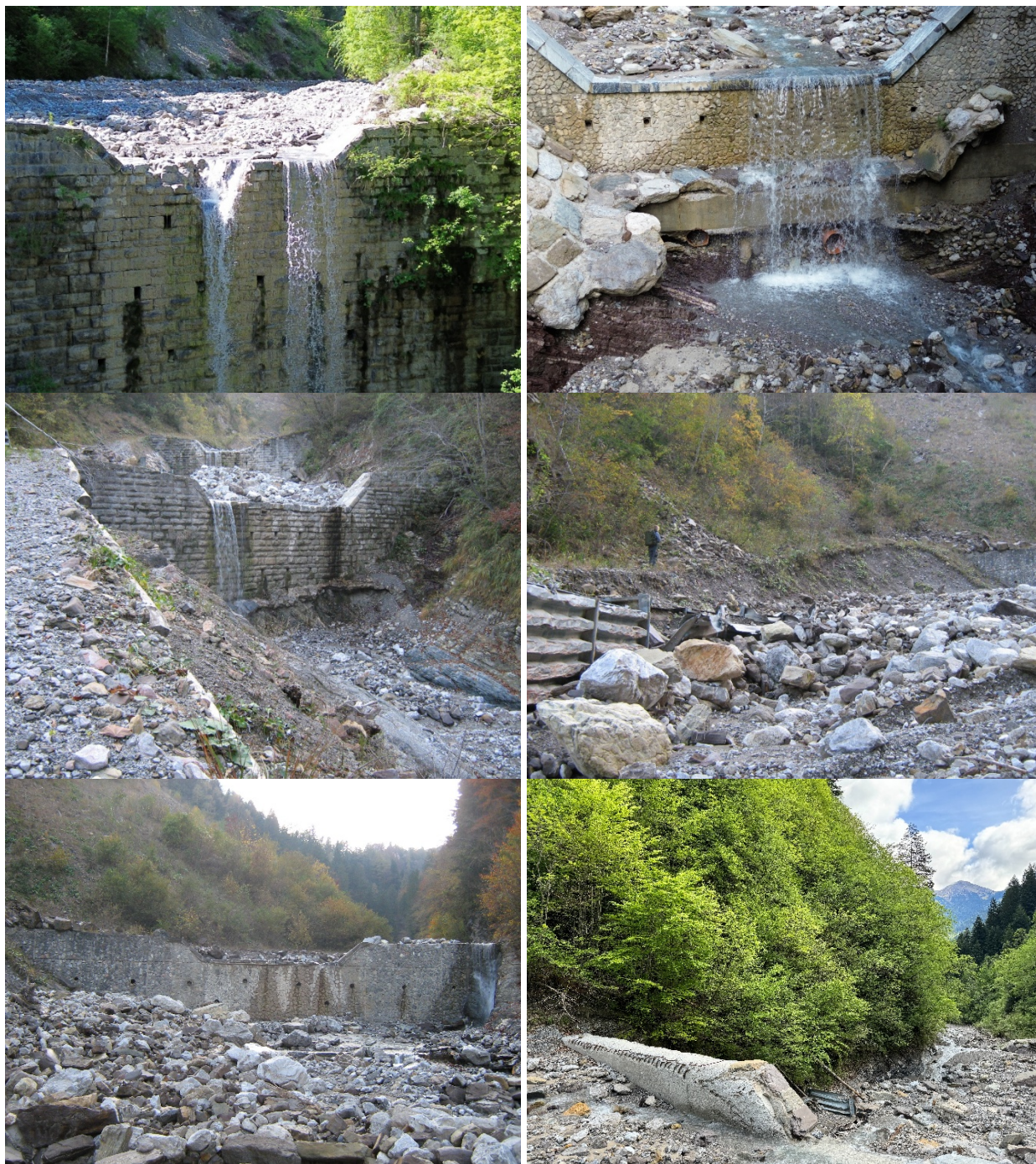
Figure 11: esempi di briglie presenti lungo l'asta principale del torrente Ortegla, censite nel 2024. a) briglia n. 030 con gaveta danneggiata; b) briglia n. 080, costruita nel 2018, e nel 2024 presenta la platea distrutta; c) briglia n. 100 realizzata negli anni '30 e nel 2024 mostra significativi processi di erosione al piede; d) opera spondale n. 121 parzialmente distrutta da una colata detritica; e-f) briglia n. 130 realizzata nel 1997 e attualmente danneggiata.
